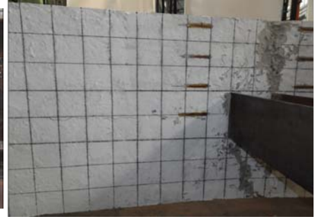
(d) Cracking pattern at top of slab
