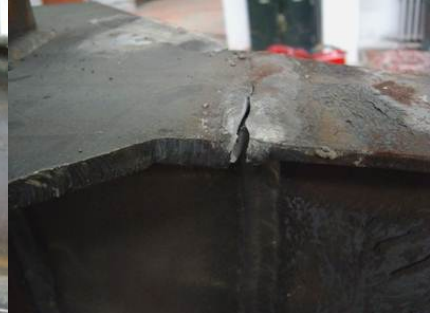
(d) Fracture of weld seam in top flange
