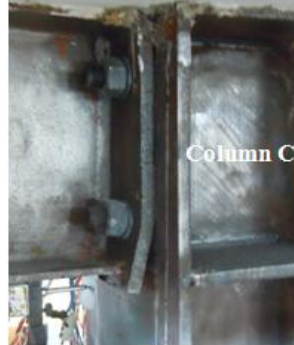
(d) Gap in the connection
